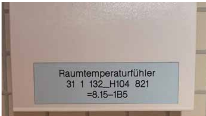
Abb. 1: Raumtemperaturfühler in einem großen Hallenbad mit vermeintlich „sprechenden“ Bezeichnern
